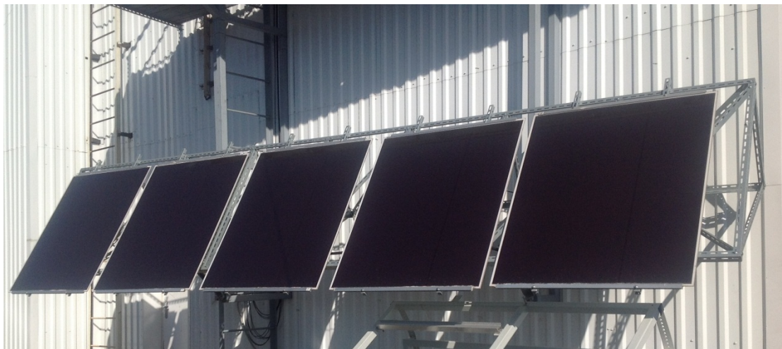
Рис. 2. Внешний вид фотоэлектрических модулей на поворотной конструкции.
