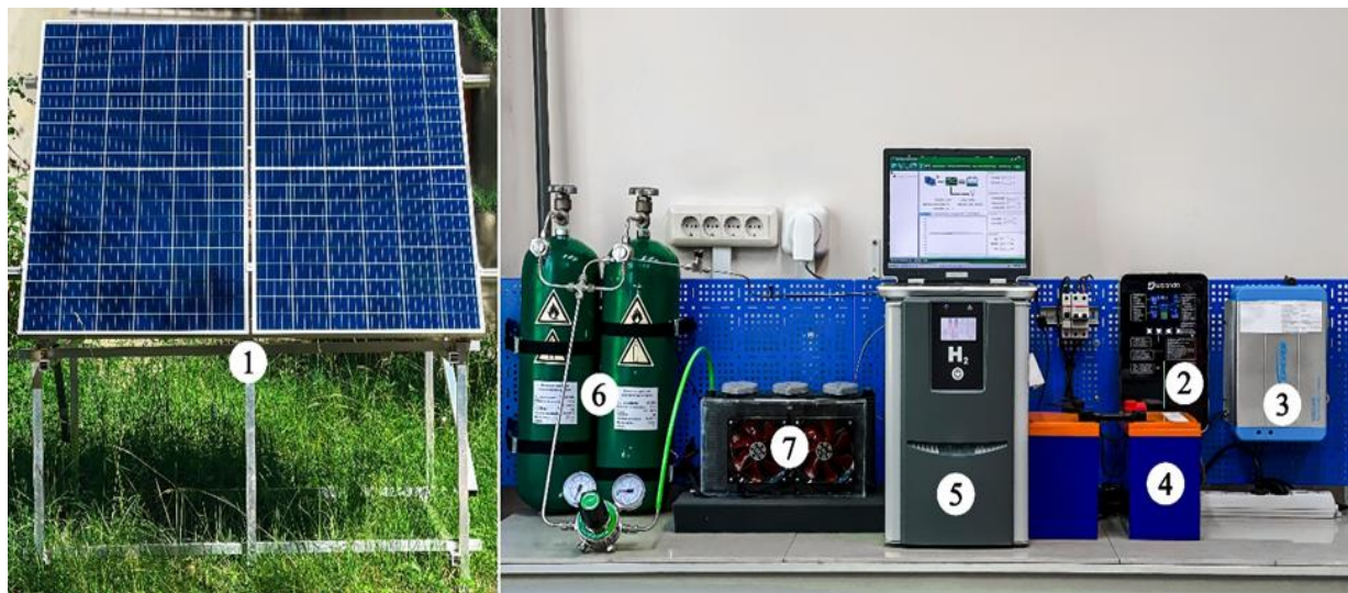
Рис. 1. Водородная система аккумулирования электроэнергии, разработанная в ИПХФ РАН: 1 – солнечные панели, 2 – контроллер заряда, 3 – инвертор, 4 – электрохимические батареи, 5 – электролизный генератор водорода, 6 – металлгидридные аккумуляторы водорода, 7 – топливный элемент.
