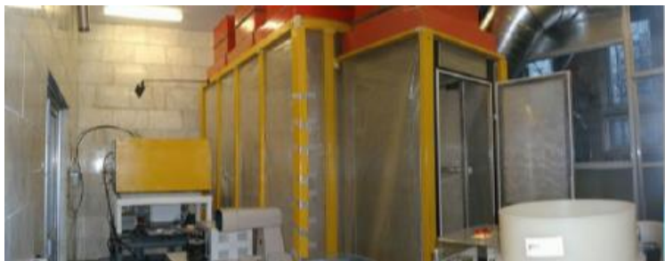
Рис. 65. Вид на «чистую комнату» для ЭНЛ с открытой входной дверью. Справа сверху блоки фильтров воздуха, ещё правее видны мощные вентиляционные трубы, подводящие воздух
